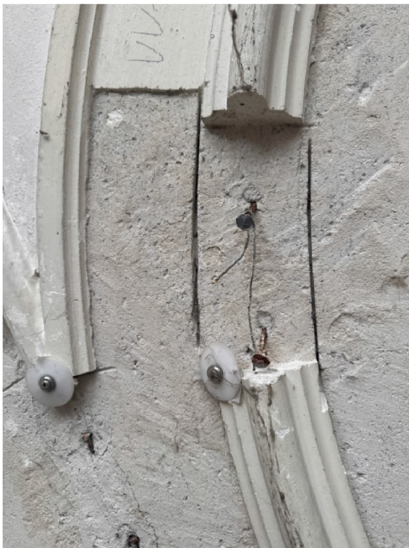
Abb. 25 © D&F Restaurierung GbR, 2019 OPH - Fehlstelle im Putz & Stuckprofil
