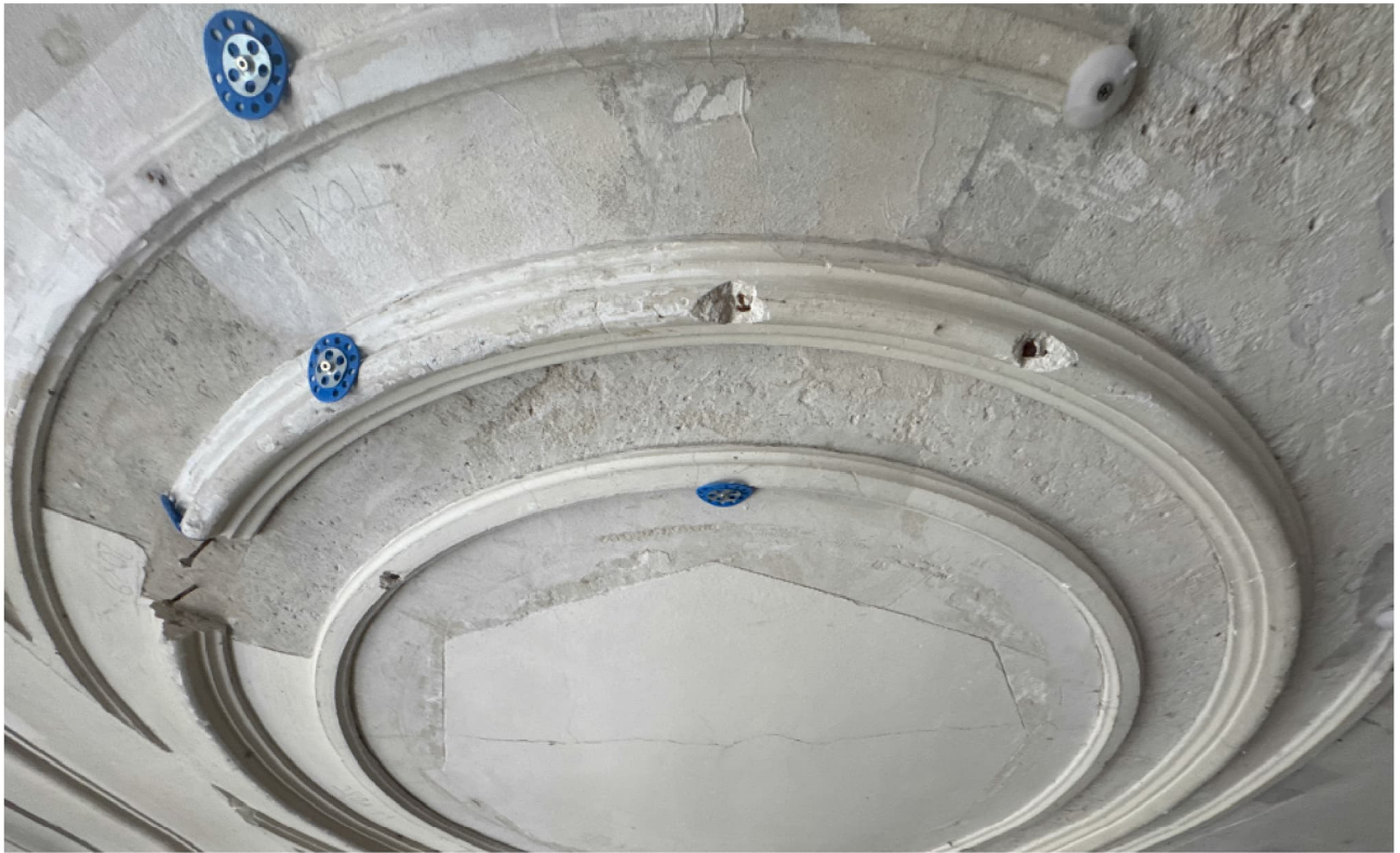
Abb. 24 IMG_9505.JPG Östliche Pflanzenhalle - Fehlstellen in Stuckdecke, Vorzustand 2025
