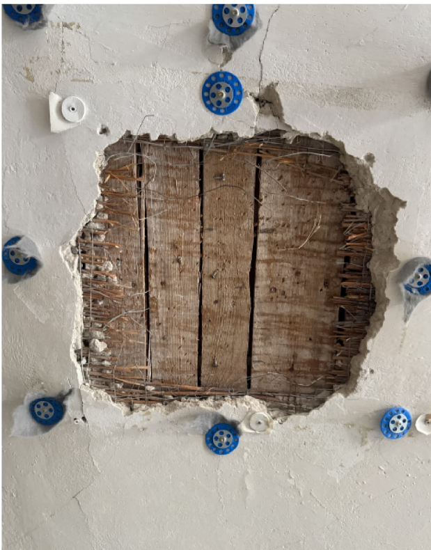
Abb. 20 © D&F Restaurierung GbR, 2019 OPH - Fehlstelle Putz & Putzträger
