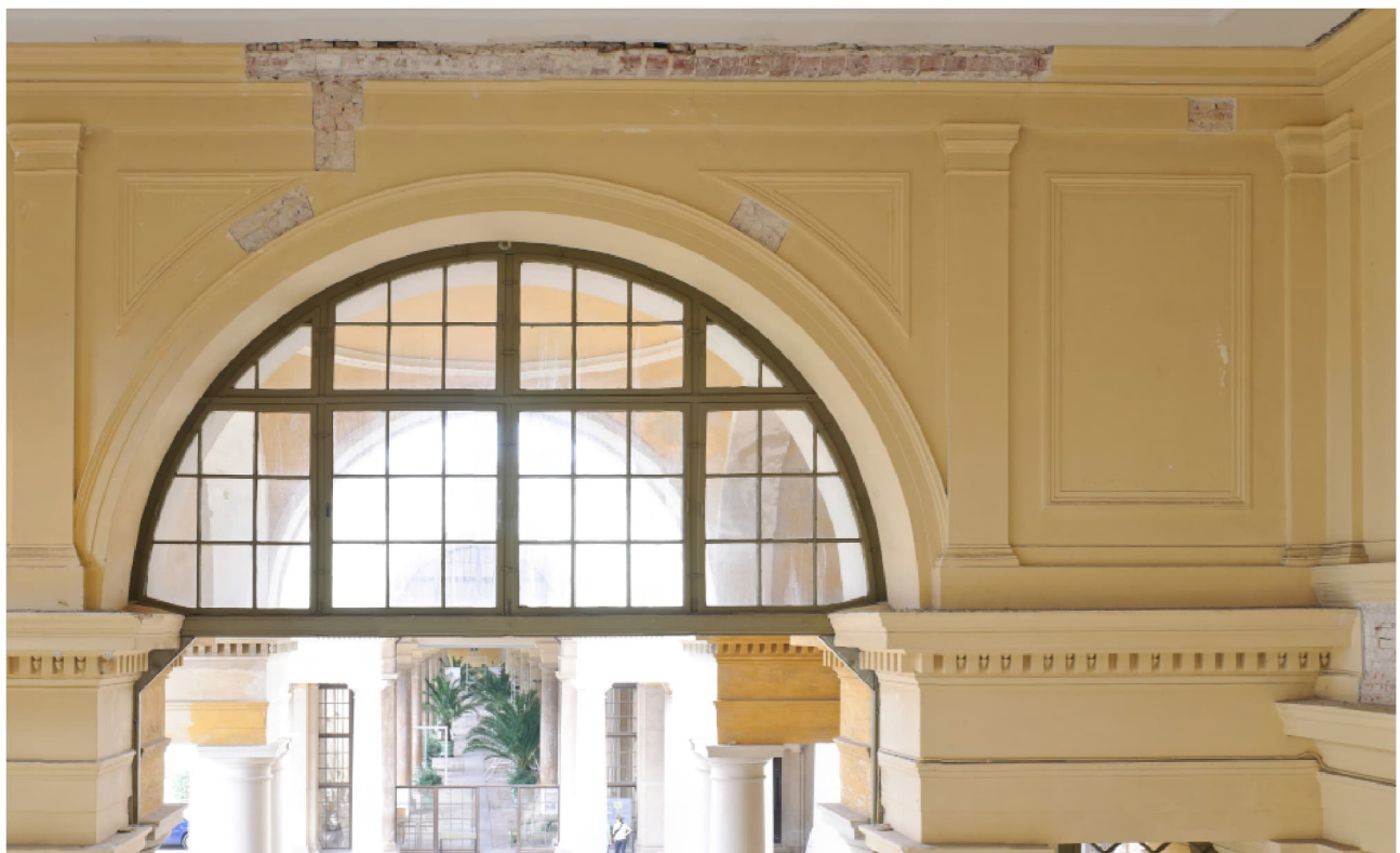
Abb. 08 Orangerie-9-Westseite.jpg Östliche Pflanzenhalle - Joch 1, Blick zum Säulenhof, Vorzustand, © Wandwerk, 2011
