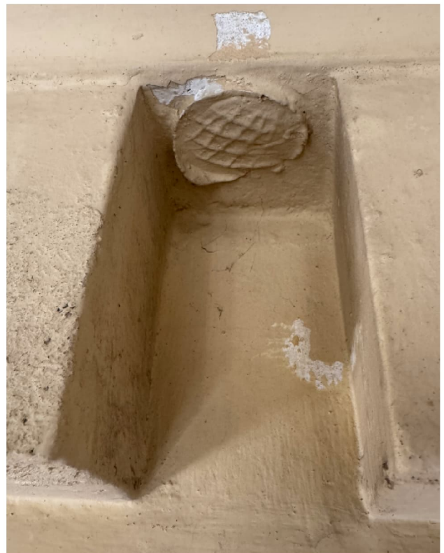
Abb. 13 20206-03-06 ML_030 OR.JPG OPH - Fehlender Stuckzapfen, Gipsplombe
