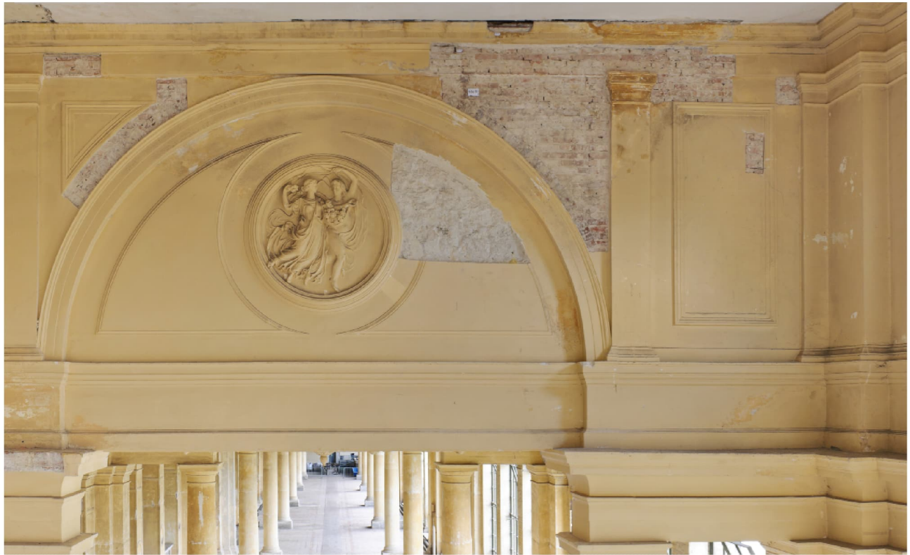
Abb. 07 Orangerie-9-Ostseite.jpg Östliche Pflanzenhalle - Joch 1, Vorzustand, © Wandwerk, 2011
