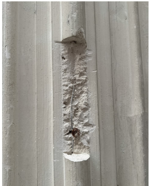
Abb. 26 IMG_9501.JPG OPH - Fehlstelle im Stuckprofil
