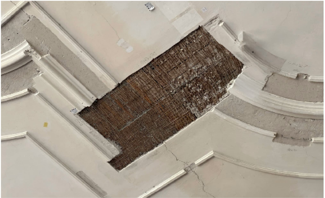
Abb. 19 2024-07-30 MJ_047 OR.JPEG Östliche Pflanzenhalle - Fehlstellen in Stuckdecke, Vorzustand 2025
